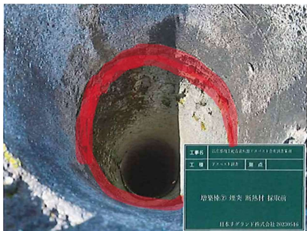
①煙突断熱材（増築棟）
