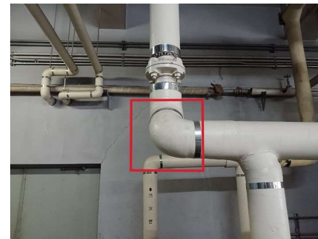
③配管エルボ保温材
